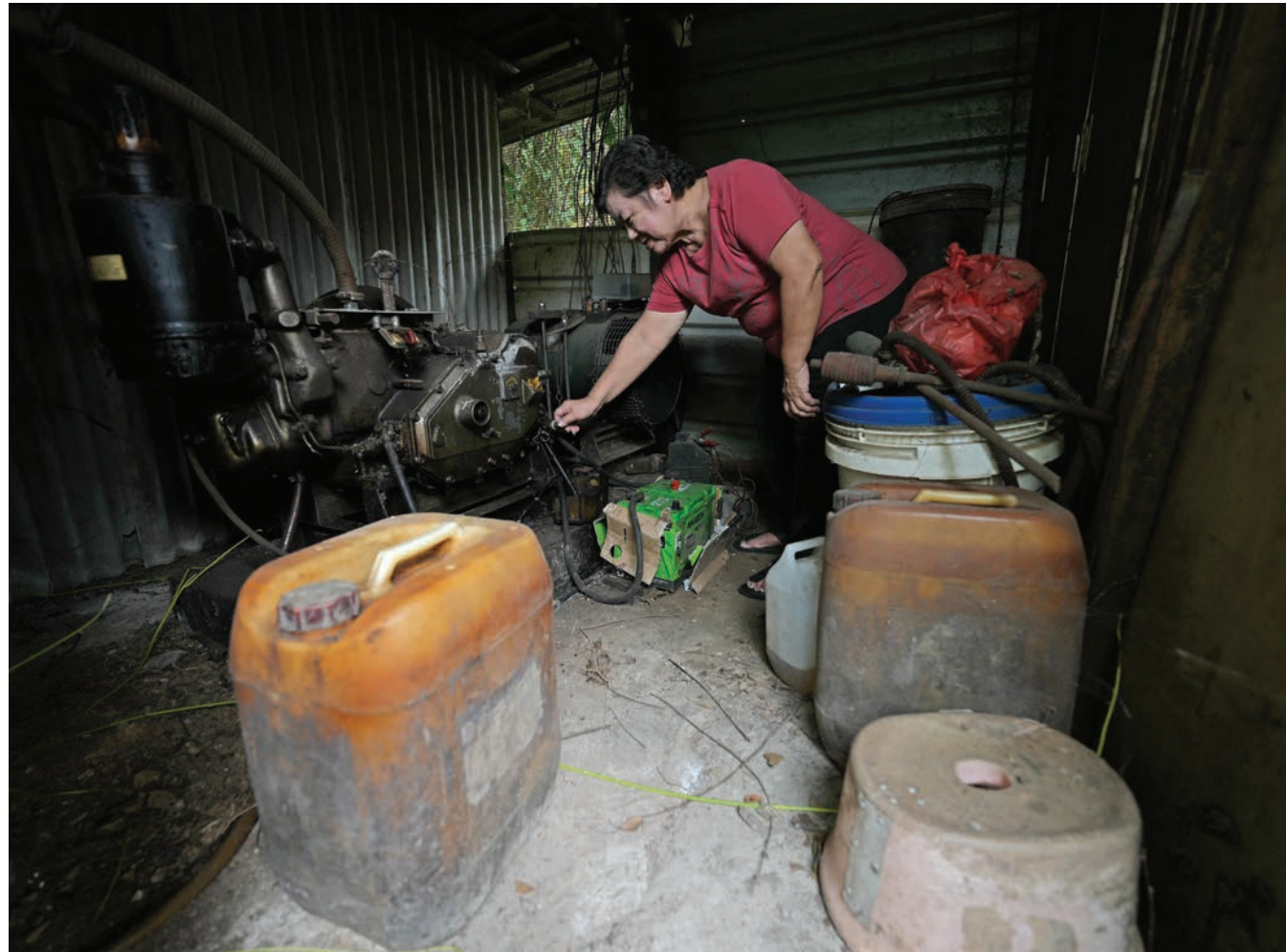
Madame Ng con los generadores diésel de su tienda, que ahora solo utiliza como reserva durante los cortes de electricidad
