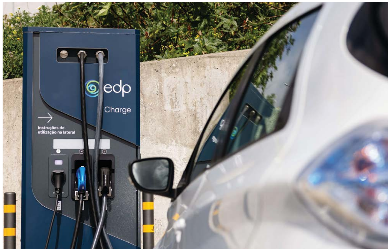
Posto de carregamento elétrico
