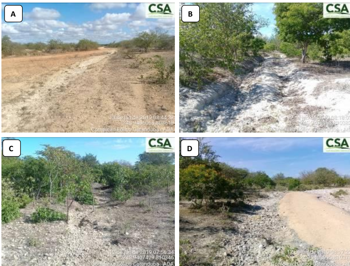
Foto 24 – A) Sulcos erosivos as margens de estrada carroçável na porção central da ADA do Parque Eólico Catanduba RN I; B) Processos erosivos na porção leste da AID do Parque Eólico Catanduba RN I; C) Erosão na porção leste da ADA do Parque Eólico Catanduba RN I; D) Processos erosivos em estrada localizada na porção leste da AID do Parque Eólico Catanduba RN I.
