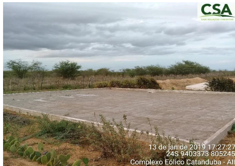
Foto 120 – Sistema para coleta de água da chuva para o abastecimento de cisternas, na zona rural de Jandaíra, All do empreendimento.
