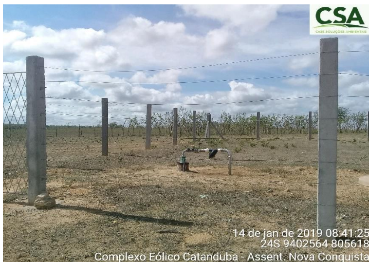
Foto 122 – Estrutura para captação de água de poços no Assentamento Nova Conquista, zona rural de Pedro Avelino/RN.
