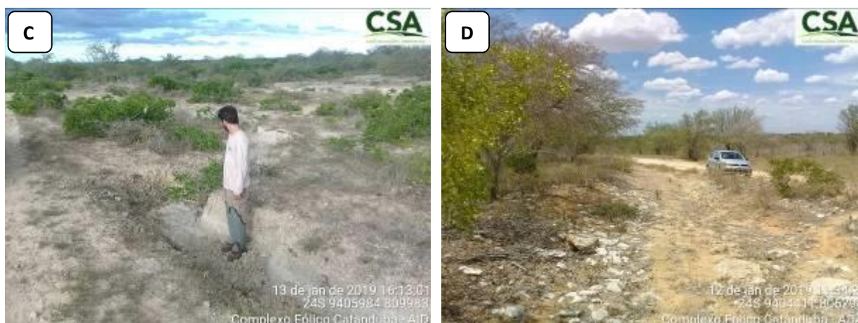
Foto 25 – A) Erosão as margens de um rio localizado na porção sudeste da ADA do Parque Eólico Catanduba RN II; B e C) Ravinas encontradas na porção leste da AID do Parque Eólico Catanduba RN II; D) Sulcos erosivos na porção sudoeste da ADA do Parque Eólico Catanduba RN II.
