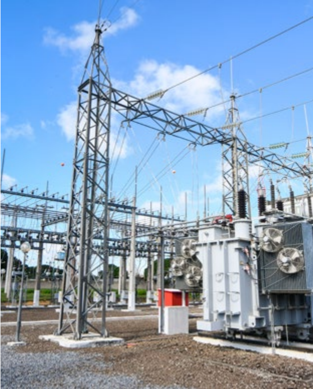
São Mateus Substation, EDP Espírito Santo
