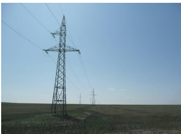
Figura 7 – Vedere a liniilor de transmisie
