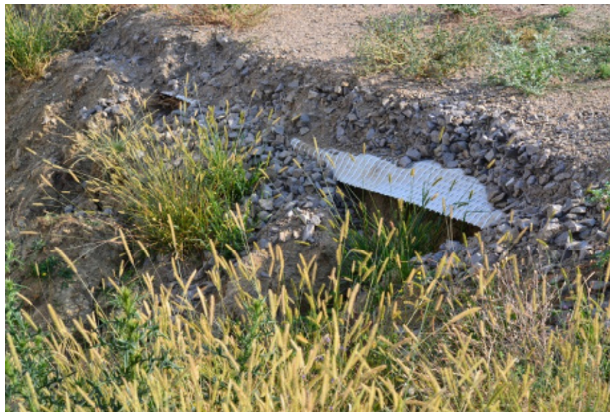
Fig. 21 – taluz de platforma afectata de ploi
