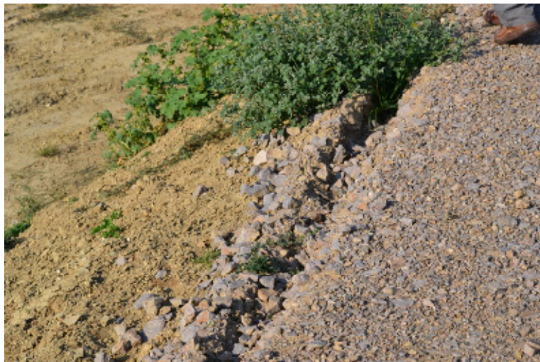
Fig. 22 –23 – fenomene de siroire care au afectat taluzele platformelor
