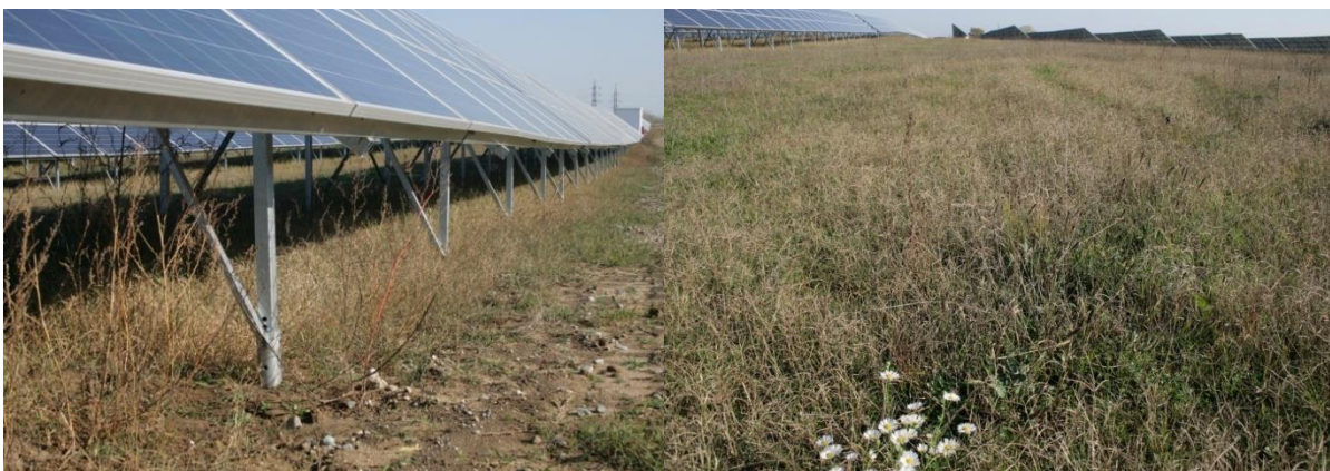
Fig. nr. 3 Aspecte din imprejurimile (sus) si interiorul (jos) parcului fotovoltaic
