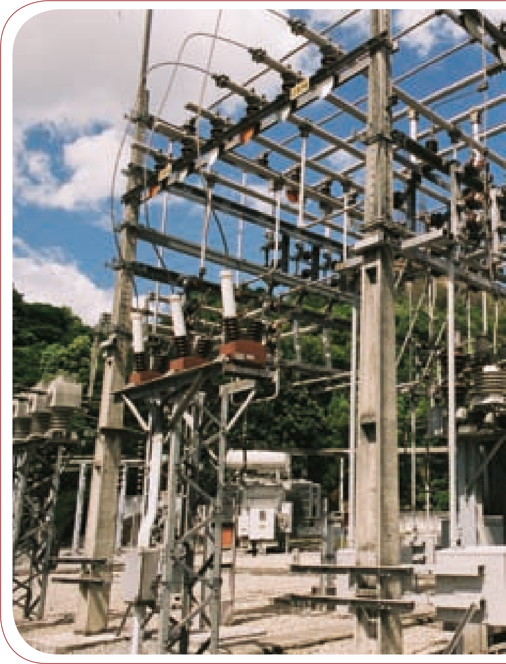
Subestação Bento Ferreira - ES
