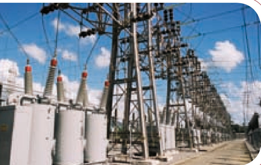
Subestação Carapina (ES)
