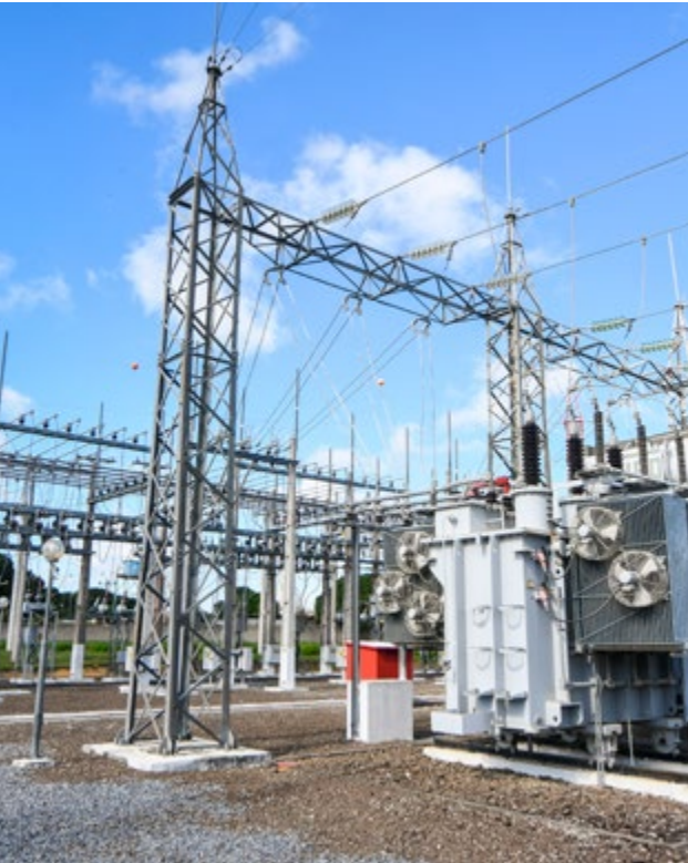
Subestação São Mateus, EDP Espírito Santo
